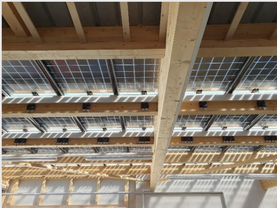
Installation intégrée de 110 panneaux de 325 Wc
