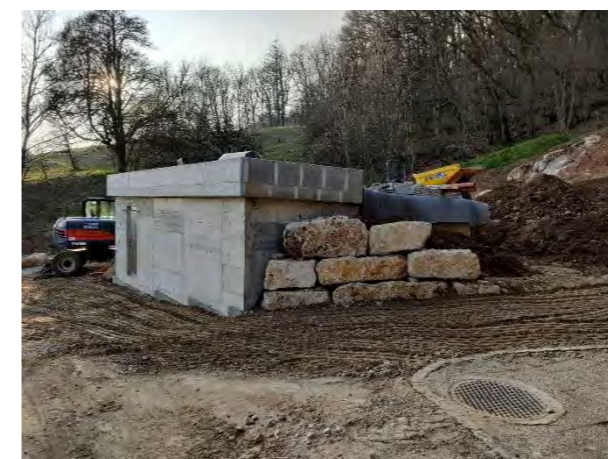
Réservoir de Combazin
