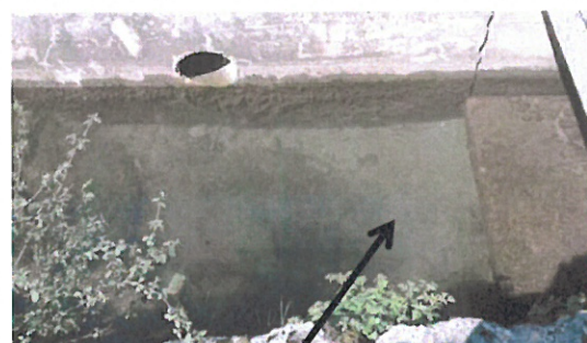
Erosion du lit à l'amont du pont de Jolimont
