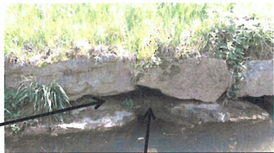
Dépôt de sable sur les blocs
