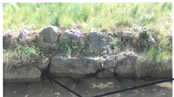
Formation de vides entre les blocs
