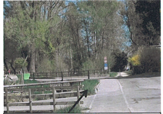
Déformation et déversement de la bordure en pavés
