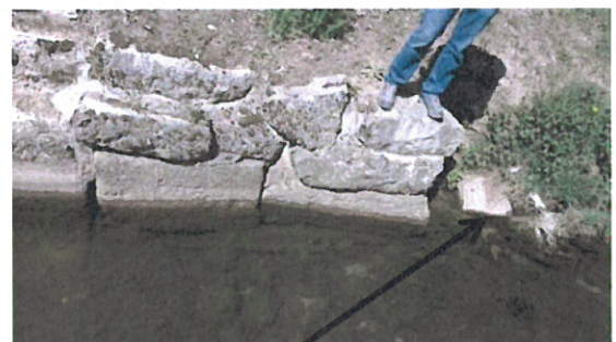
Erosion en rive gauche due à l'exutoire du trop-plein de la STEP
