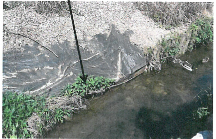
Emportement d'une partie de la berge par érosion
