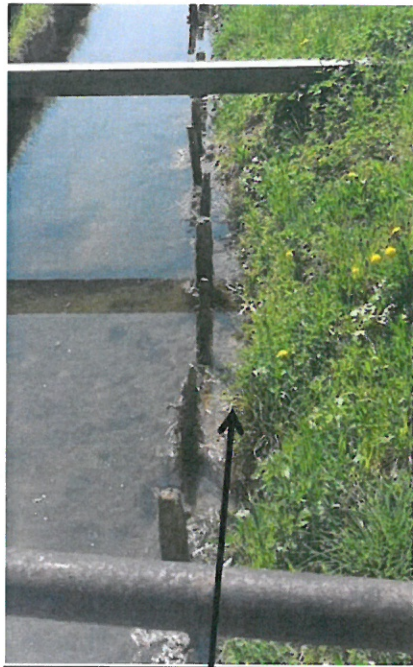
Disparition de protection en bois (seul les pieux en bois sont encore présents) et régression du pied de berge par érosion.
