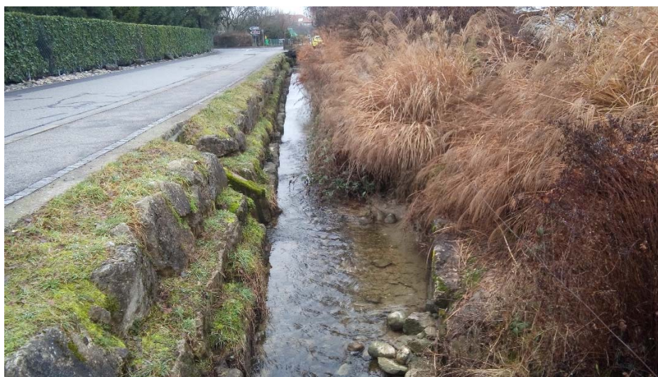
Tronçon actuellement sans protection contre les chutes
